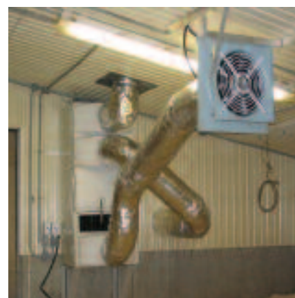
Un des deux POLYMAIR MD installés verticalement dans la salle d'élevage sur litière.
