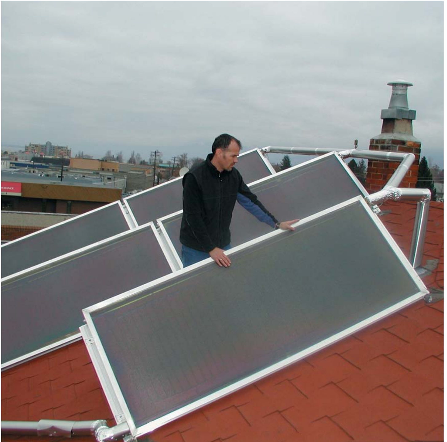
Panneaux solaires. Association des industries solaires du Canada.
