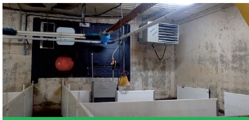
Échangeur de chaleur air-air ESA-3000 vu de l'intérieur.
