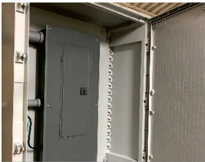
À défaut d'installer les panneaux électriques dans une chambre fermée à cet effet, on peut les insérer dans une armoire pour les protéger de la corrosion.
