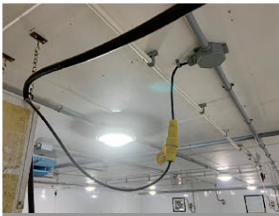
L'installation de prise bien étanche éloigne les risques d'incendie attribuables à la corrosion de l'équipement.
