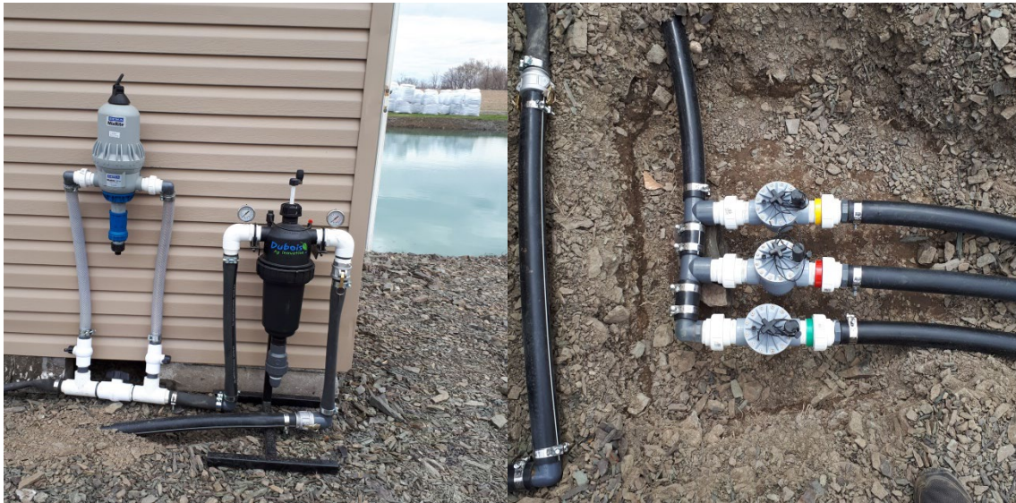
Photo 6 : Injecteur (à gauche sur la photo de gauche), filtre (à droite sur la photo de gauche) et valves (à droite sur la photo de droite) Source : Philippe-Antoine Taillon, MAPAQ
