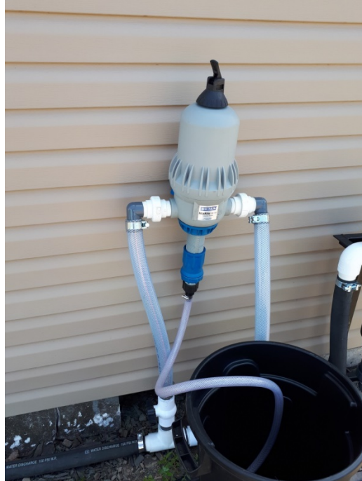
Photo 12 : Injecteur MixRite et récipient pour l'acidification de l'eau d'irrigation et la fertigation Source : Philippe-Antoine Taillon, MAPAQ
