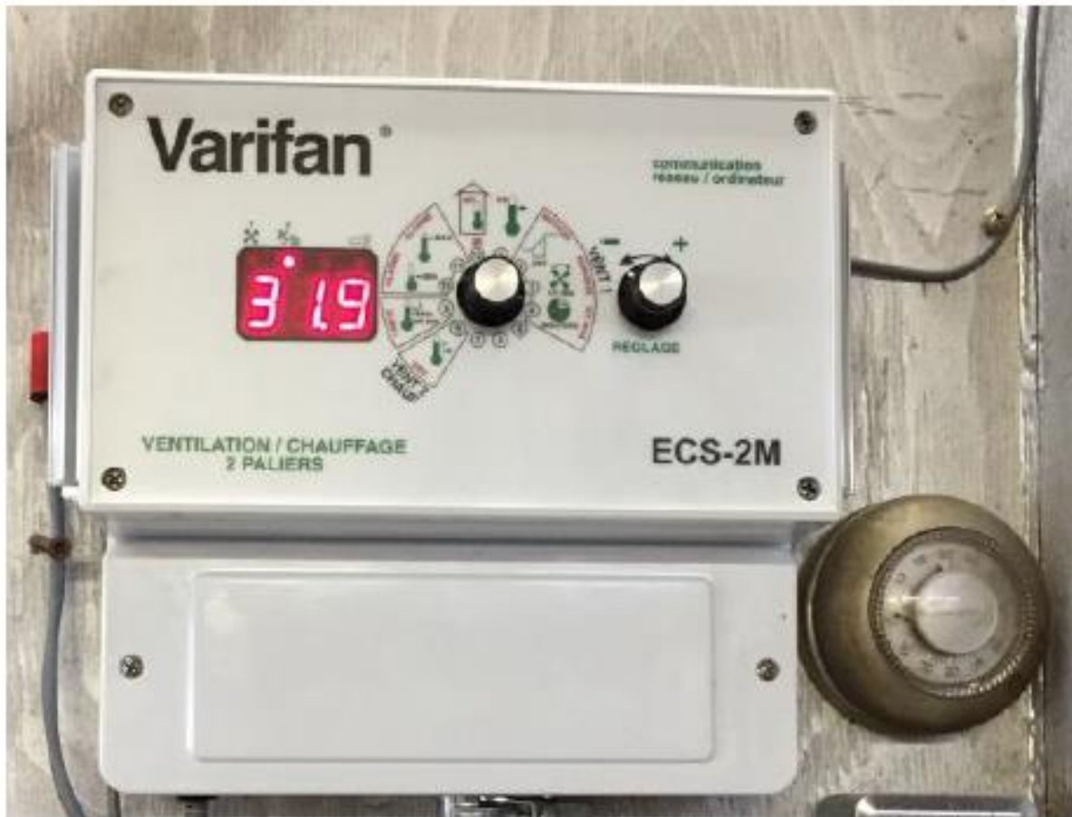
Contrôleur ECS-2M; 2 paliers (ventilation et chauffage)
