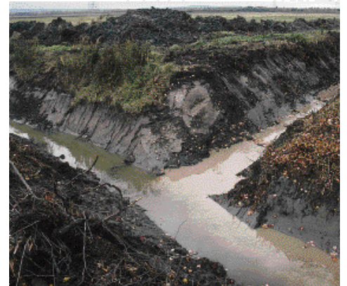
Cours d'eau chargé de matières en suspension à la suite des travaux de nettoyage
