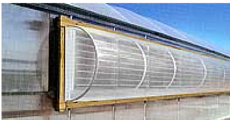
Photo 7 : Surface d'entrée d'air arrondie et recouverte d'une moustiquaire; cette surface arrondie est environ 1,6 fois plus grande que l'ouverture originale.
