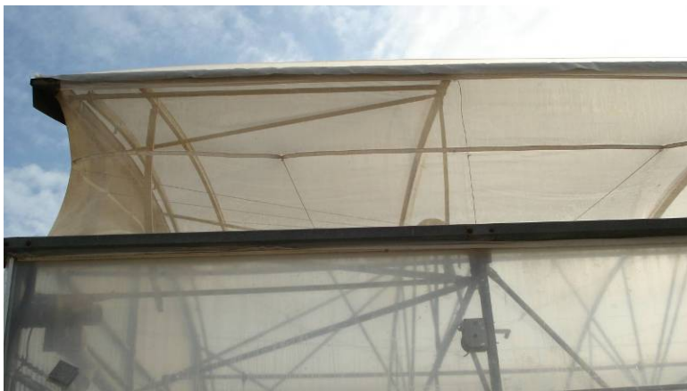
Photo 6 : Moustiquaire « Ultravent » installée en ventilation à la gouttière.
