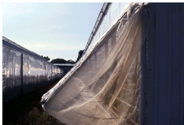
Photo 12 : Moustiquaire installée sur le côté ouvrant d'une serre.
