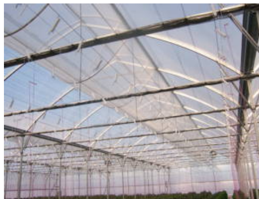
Photo 14 : Autre façon d'installer une moustiquaire pour une ventilation naturelle au toit; la moustiquaire fait un genre de demi-cercle à l'intérieur de la serre.
