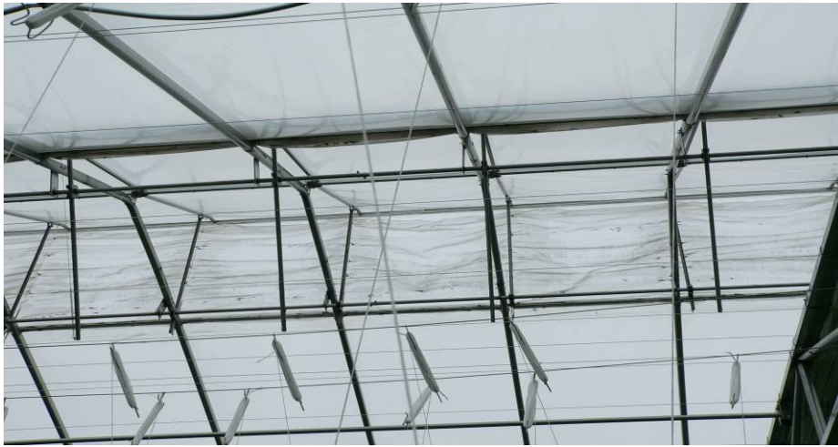
Photo 5 : Serre jumelée à ventilation au pignon, équipée de moustiquaires sur les deux côtés ouvrants du pignon; sur la photo, un des ouvrants est complètement ouvert. La moustiquaire se replie à l'intérieur de la serre lorsque l'ouvrant se referme.
